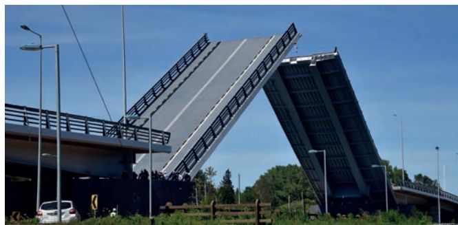
Com falhas de projeto, ponte Cau Cau teve demolição cogitada.
