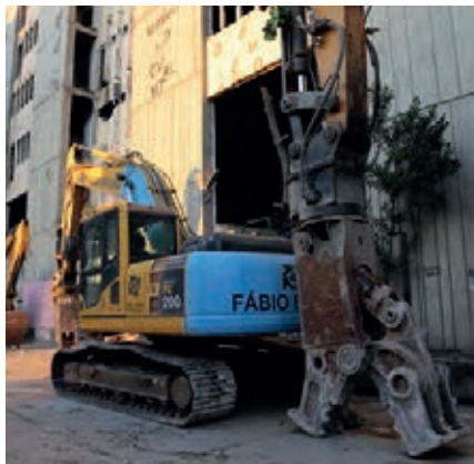
A Fabio Bruno Construções, referência em demolições no Brasil, realizou a operação no Rio.
