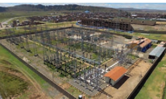
Subestação de Azángaro em Puno (Peru)
