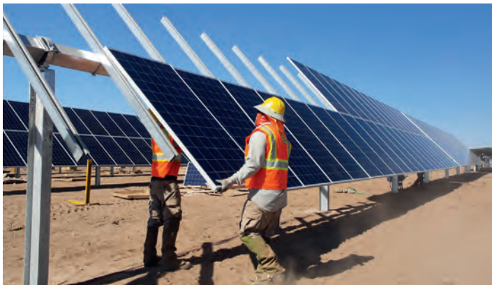
Projeto Xoxocotla terá capacidade de geração de 70MW.
