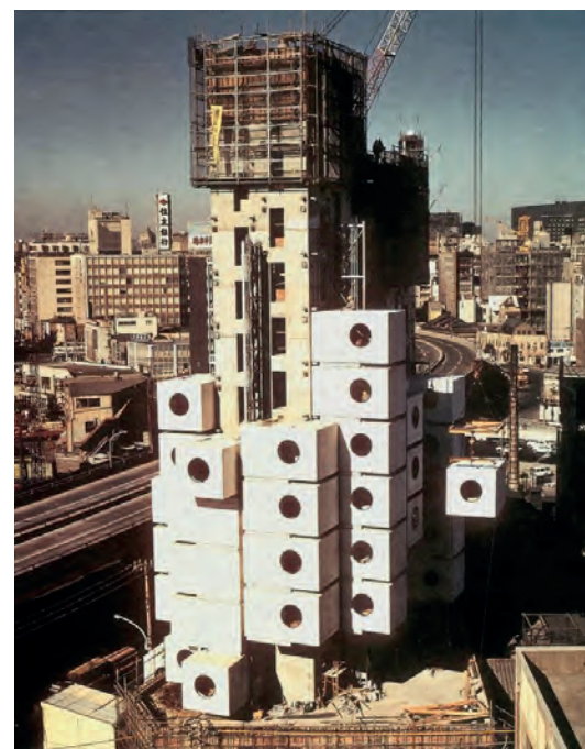
Em 1972, uma grua levantou os módulos de aço da Torre da Cápsula de Tóquio.
