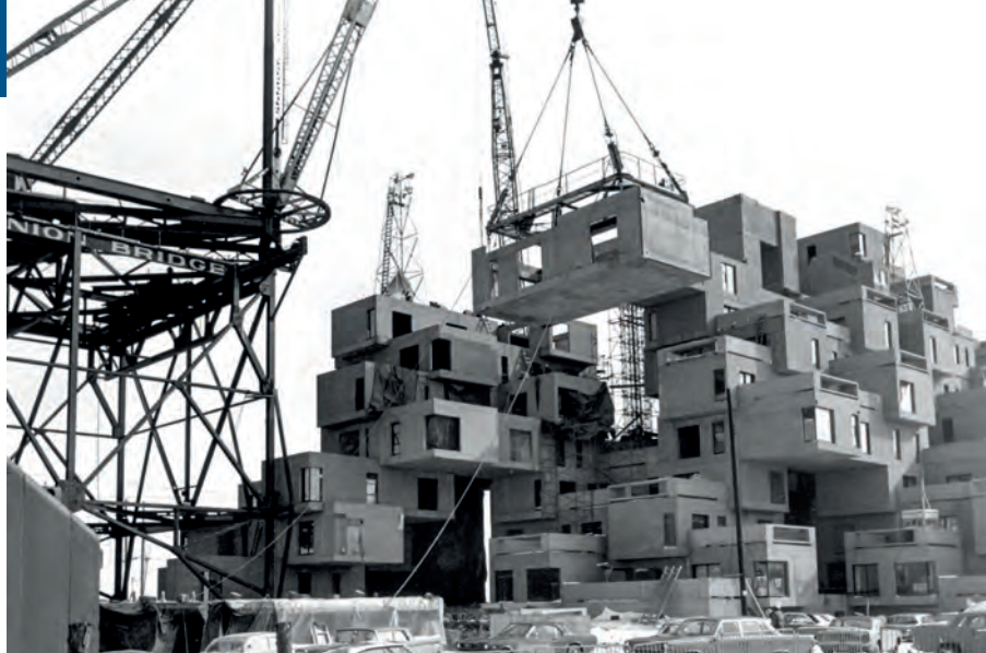
Uma grua tipo Derrick coloca módulos de concreto de até 82 toneladas para o famoso projeto Habitat 67 em Montreal, Canadá, na década de 1960.
