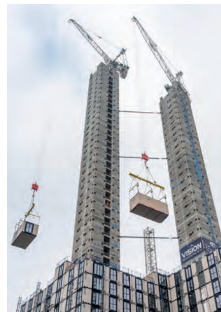
Dois Terex CTL650F-45 montadas em núcleos de construção de concreto que servem ao projeto de PPVC mais alto da Europa.
